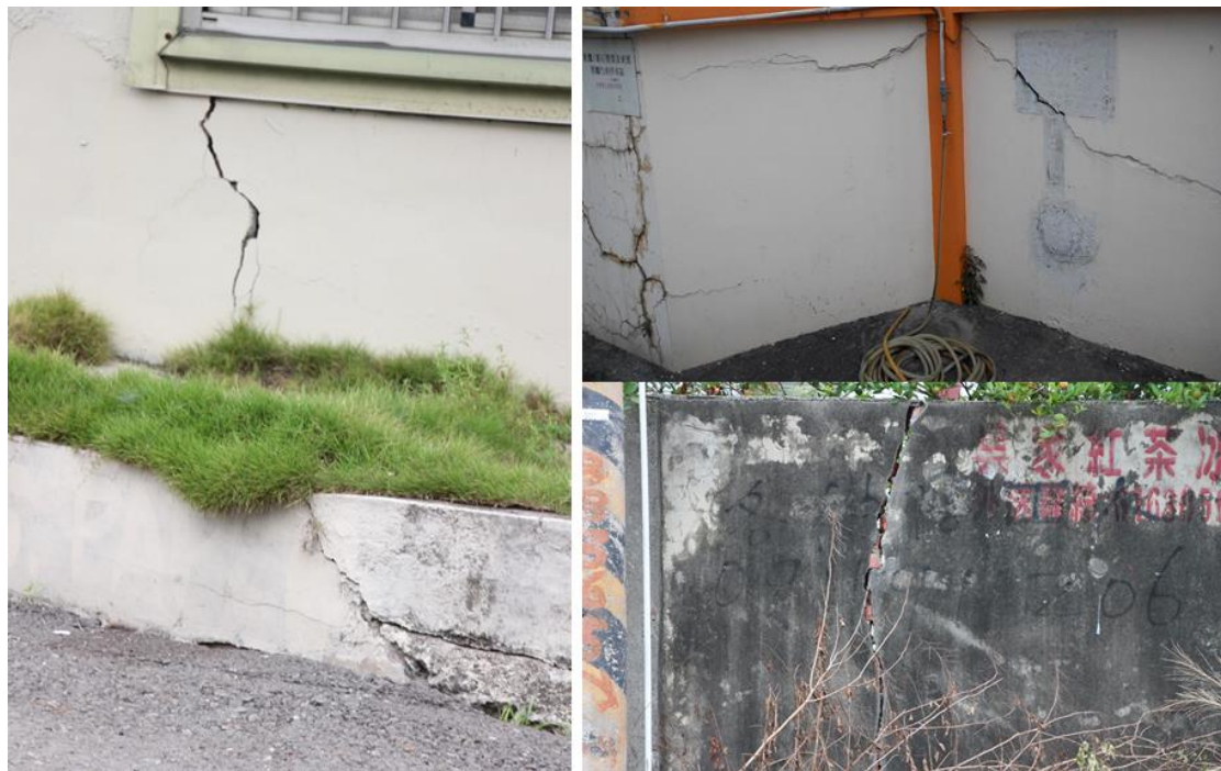
圖 17：車瓜林斷層潛移，造成結構物受破壞的現象（富國工程，2015）。
