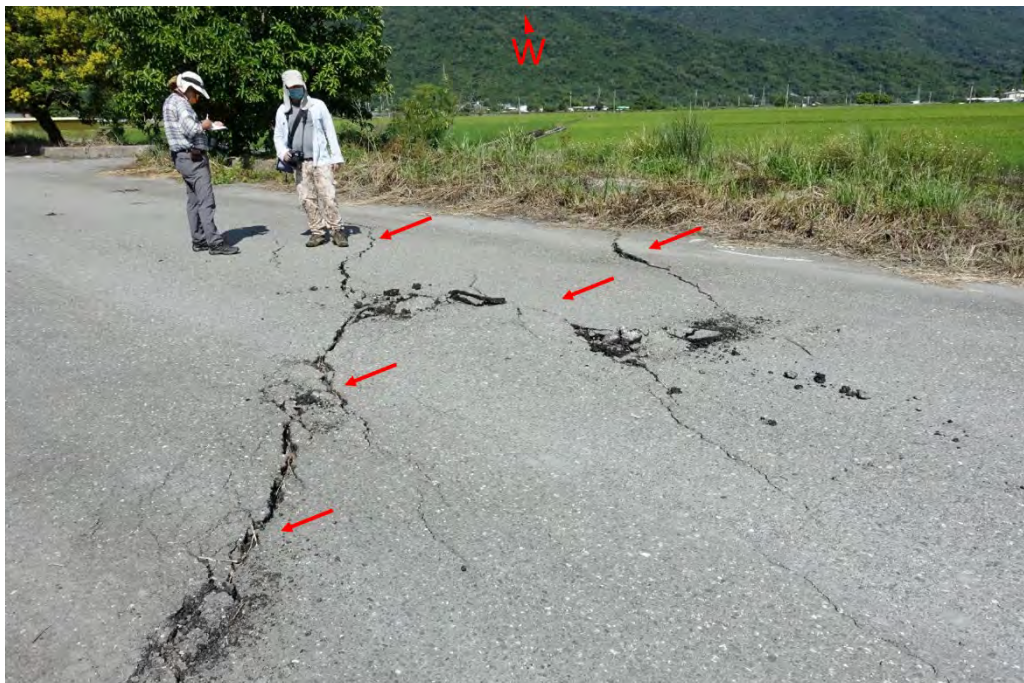
圖 11、2022 年池上地震後，客城堤防外防汛道路上一組呈現左移形式之鋸齒狀（Zigzag）裂隙，主裂隙走向 N55°W，並南北方向壓縮（周稟珊攝）。
