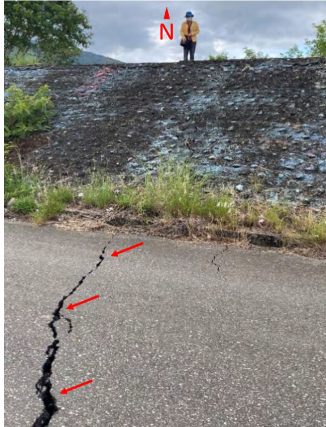
圖 8、2022 年池上地震後，玉里醫院旁卓溪南岸河堤防汛道路上有 1 組裂隙，走向 N20^{\circ}W-N24^{\circ}W ，西側上升（林啟文攝）。
