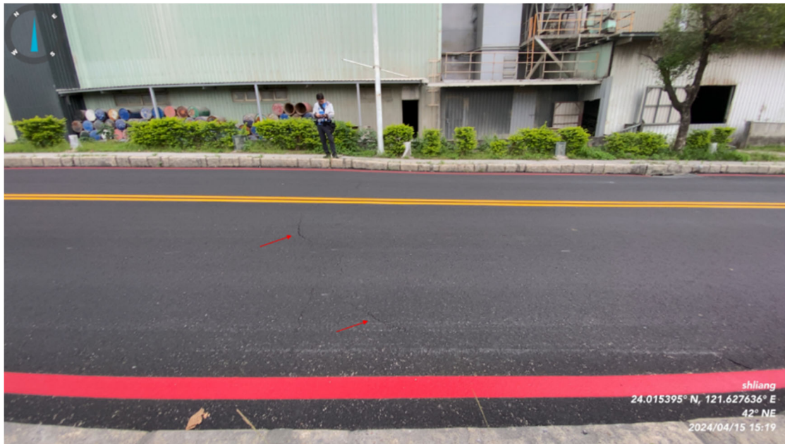
圖 23、地震力造成柏油路破壞現象，紅色箭頭處（向東北拍攝）。 （梁勝雄拍攝）
