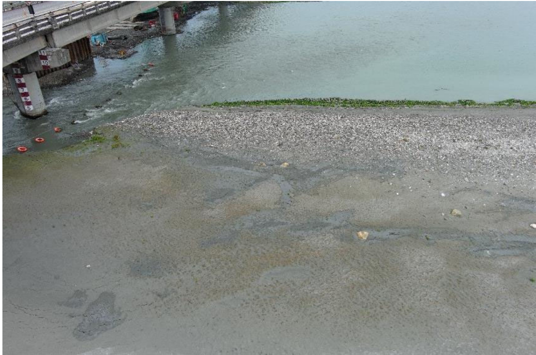
圖 21、4 月 23 日地震後，花蓮大橋東側所見噴沙與側潰現象。（謝有忠科長拍攝）
