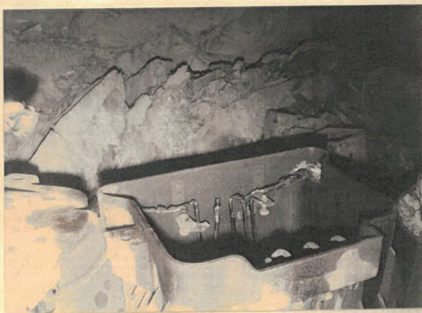
照片二 最外側一台（一次側焚燒情形）
