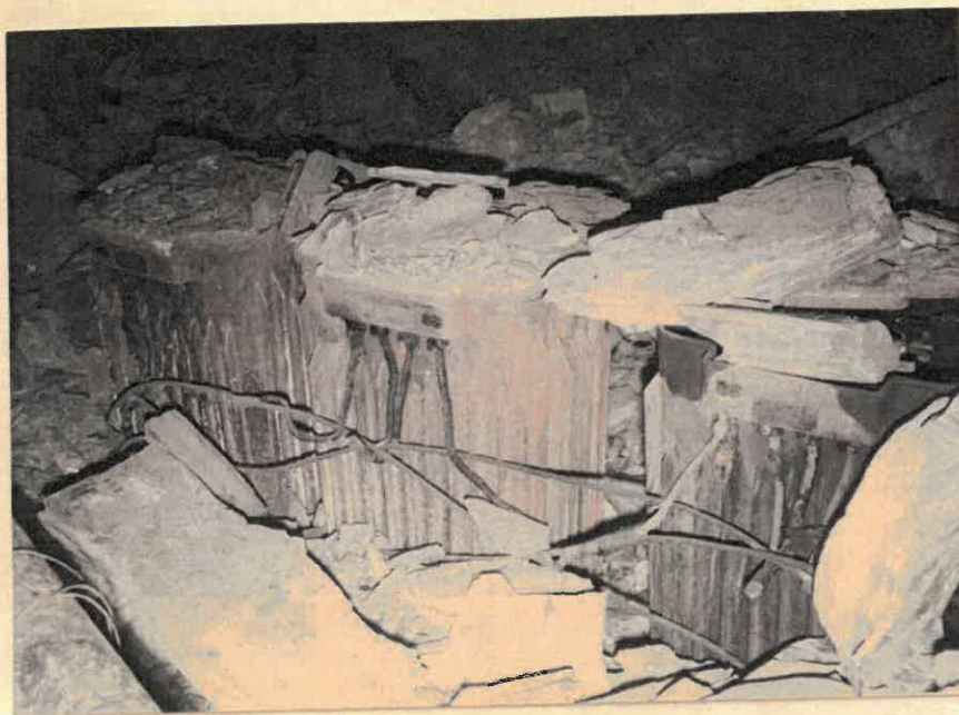
照片一 40 KVA 變壓器組
