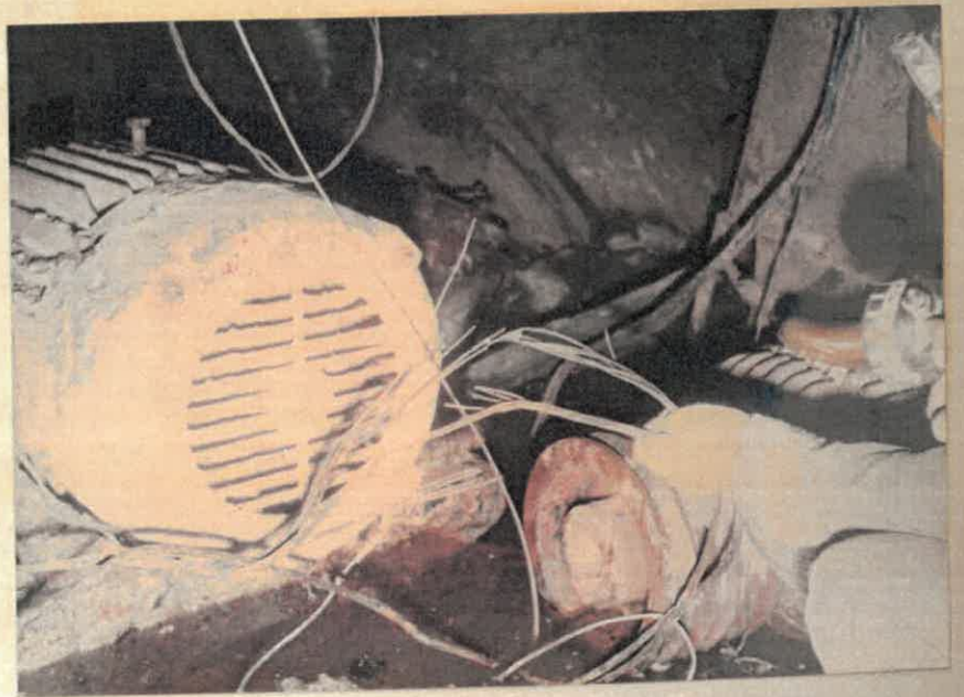
照片十四 220V 50HP 壓風機之電動機之引接線 (短路電弧所造成之斷線情形)
