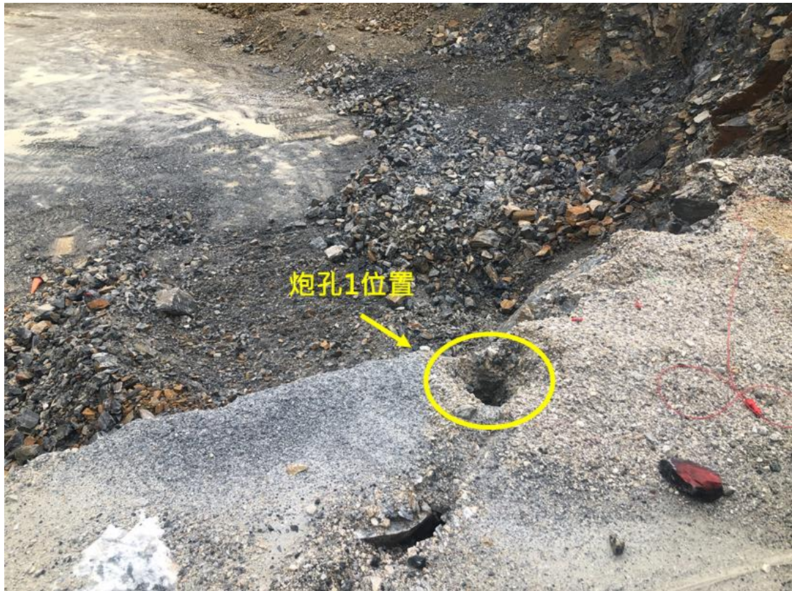
圖 10、炮孔 1 殘留 145 作業工區上層處之痕跡 (114.6.13 攝)
