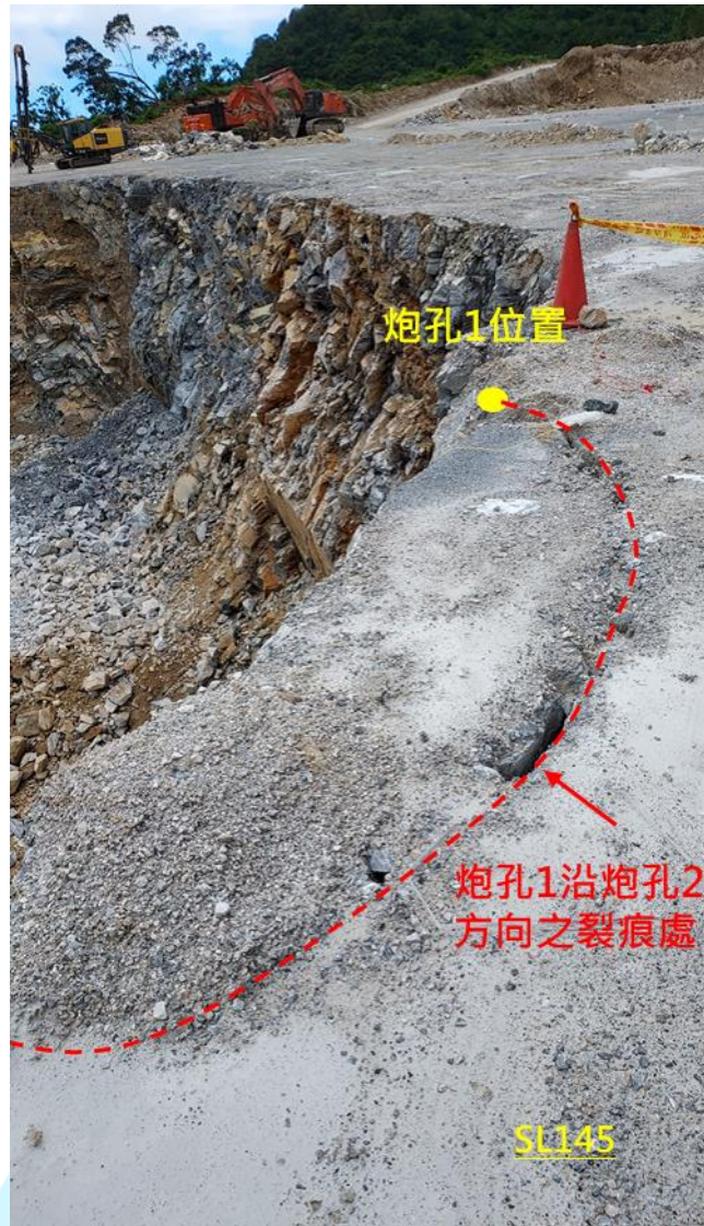
圖 9、炮孔 1 沿炮孔 2 方向之地層表面有裂痕情形（114.6.9 攝）
